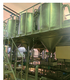
4 浸漬・充填タンク
