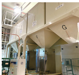
2 計量装置付き納米タンク
